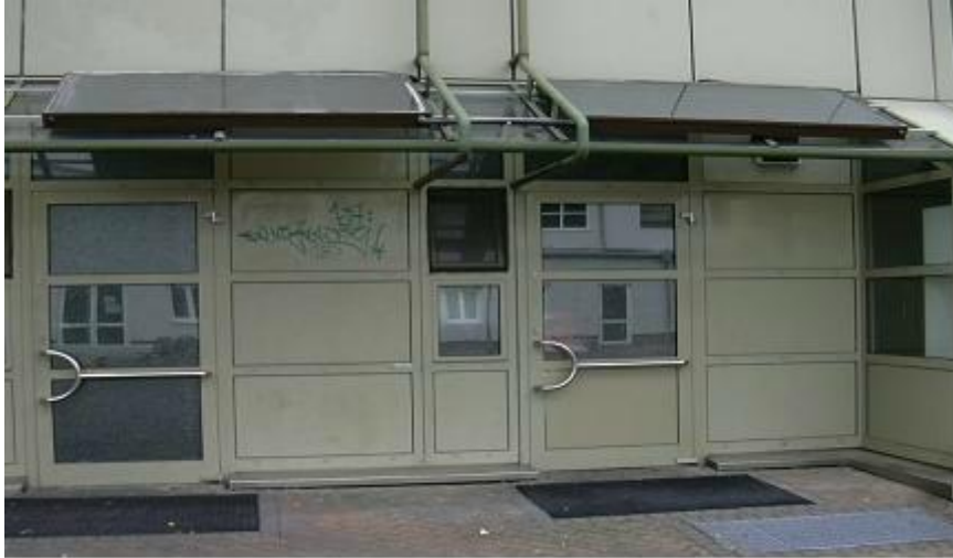
Die solar-thermische Anlage wurde teilweise aus Gebraucht- teilen von Schülern unter Anleitung des Fachlehrers installiert.
